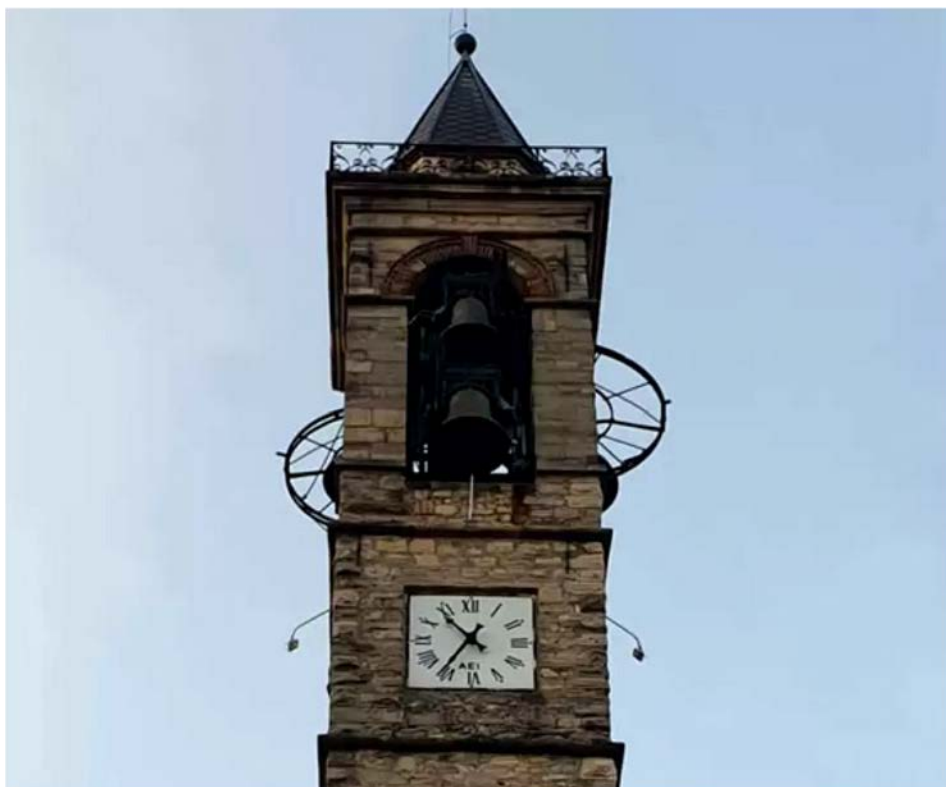
Figura 16 – Campanile della chiesa parrocchiale di Pedrengo Danneggiato dal fulmine del 26 settembre 2021
